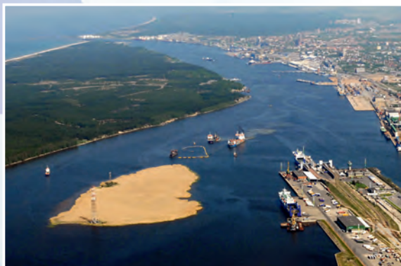
Klaipėdos valstybinio jūrų uosto laivybos kanalo gilinimo darbai The shipping channel dredging works of Klaipėda State Seaport
