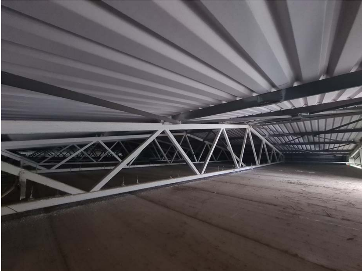
403 pav. Pastato Nr.4 stogo konstrukcijų fotofiksacija ir apmatavimai. Denginio konstrukcijų matmenys atitinka nurodytus archyvineame projekte.
