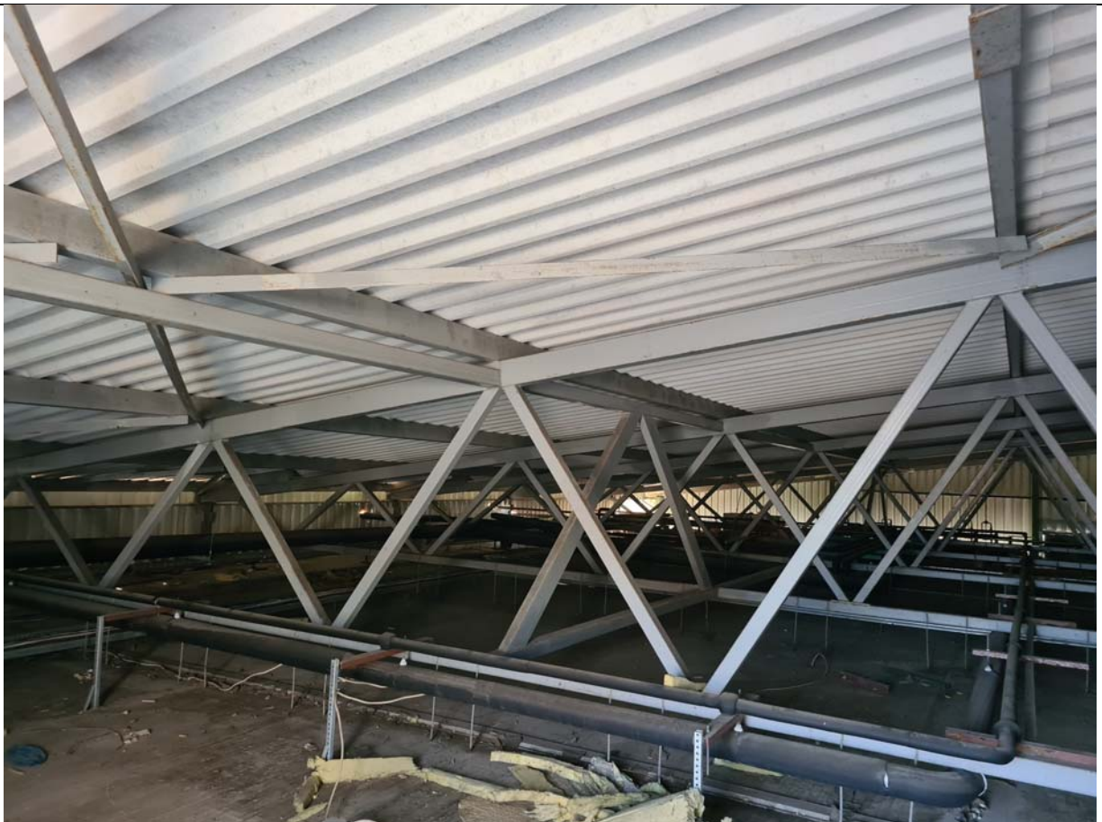
203 pav. Pastato Nr.1.2. stogo konstrukcijų fotofiksacija ir apmatavimai. Denginio konstrukcijų matmenys atitinka nurodytus archyvineame projekte.
