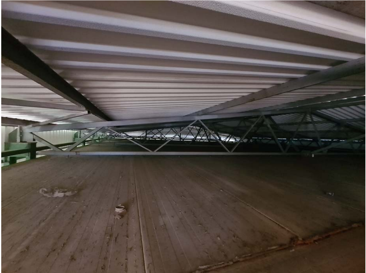
303 pav. Pastato Nr.1.3. stogo konstrukcijų fotofiksacija ir apmatavimai. Denginio konstrukcijų matmenys atitinka nurodytus archyvineame projekte.
